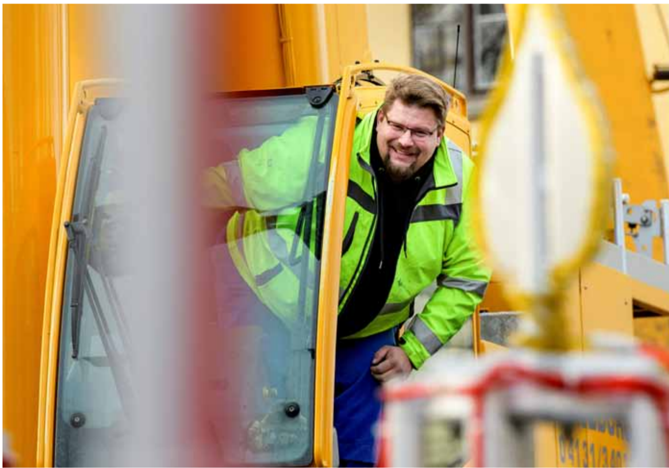
Die Krankabine ist sein Reich: Jan Wiebusch hat gestern das große Stahlgerüst auf den Wasserturm manövriert.
